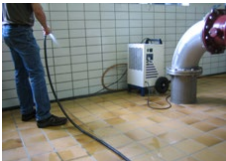
Abb. 12 Strahlwassereinwirkung auf Anschlussleitung und Betriebsmittel
