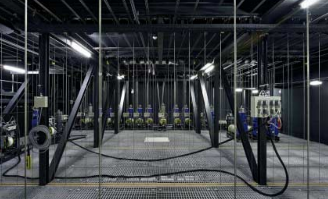
Bild 11: Maschinentechnische Einrichtungen der Obermaschinerie
