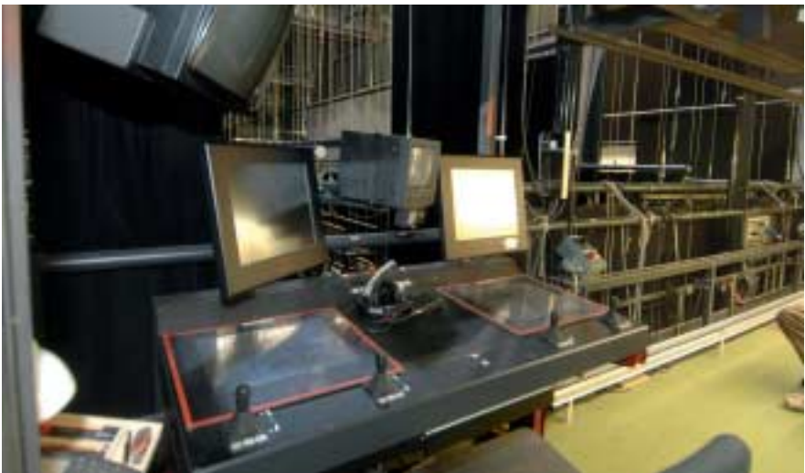
Bild 6: Steuerpult einer maschinentechnischen Einrichtung
