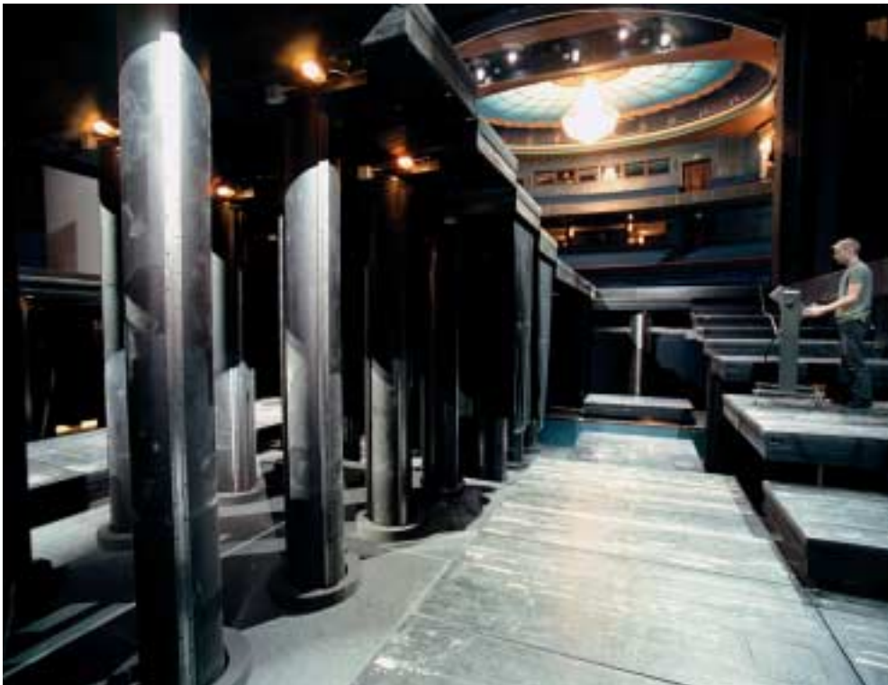
Bild 12: Maschinentechnische Einrichtung der Untermaschinerie
